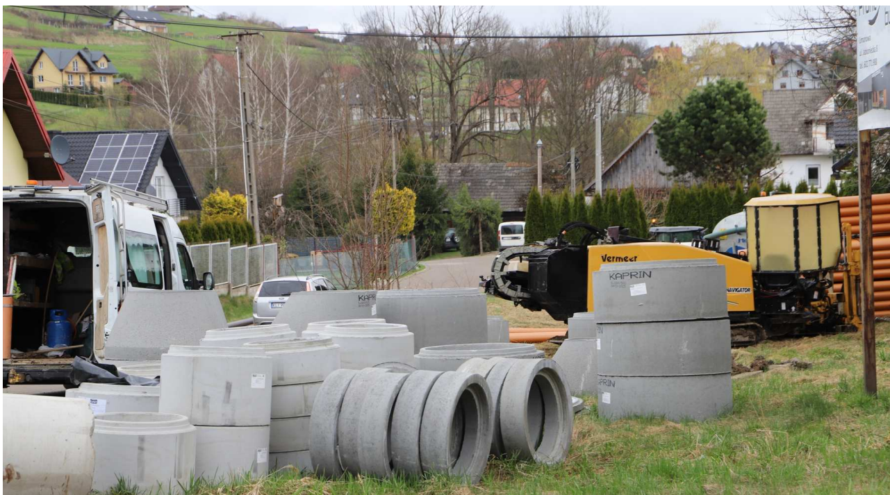
Kanalizacja sołectwa Stara Wieś
