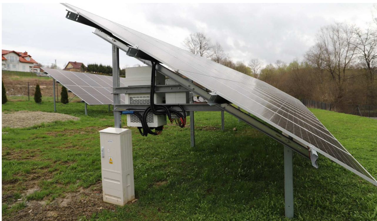
Instalacje fotowoltaiczne przy oczyszczalni ścieków w Starej Wsi
