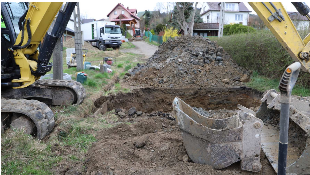
Kanalizacja sołectwa Stara Wieś
